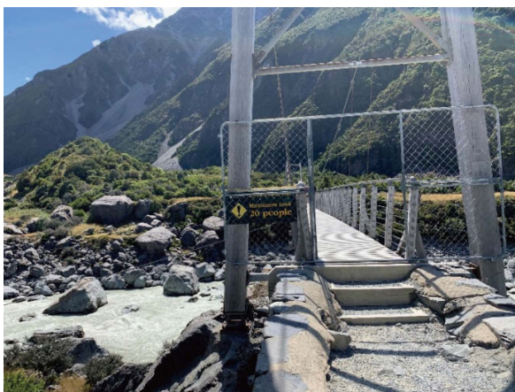
図 16 フッカー・バレー・トラックの吊り橋の段差
